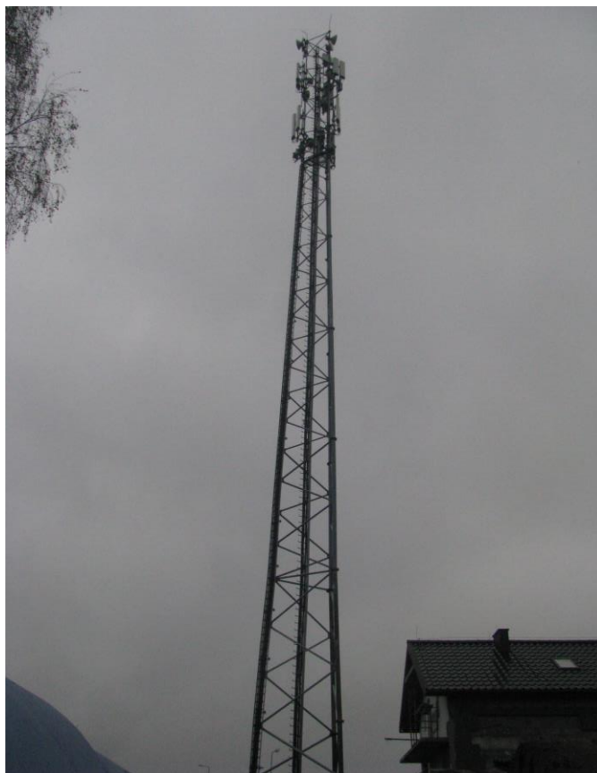
Zał. nr 1: Widok ogólny instalacji radiokomunikacyjnej.
