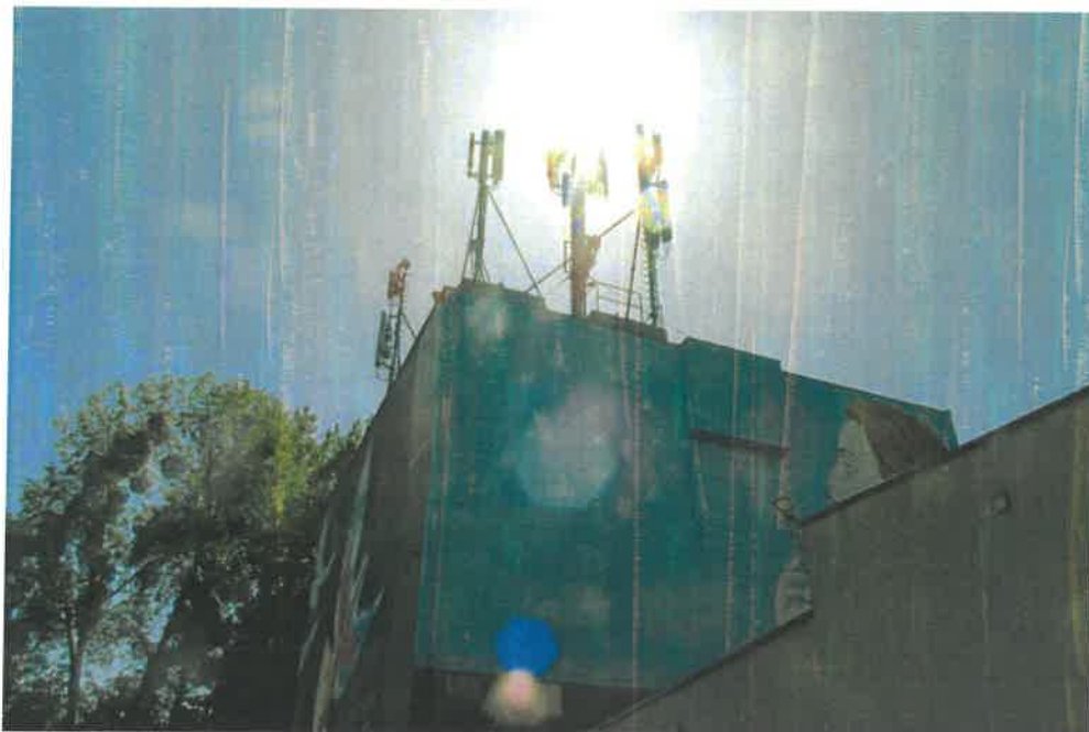
Zał. nr 1: Widok ogólny instalacji radiokomunikacyjnej.
